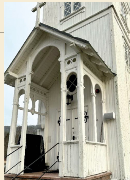
Malingsavskalling mot vest.
